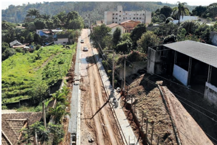
Rua Jacarandás, no bairro Sol Nascente, em Terra Preta
